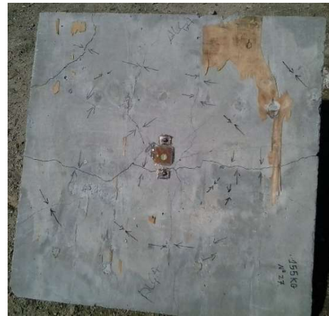
Fig. 8. Face inferior da laje 2. Trincas podem ser observadas, porém a peça não foi seccionada.
