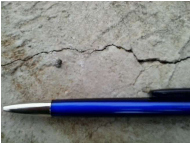
Fig. 4. Fissuras geradas na laje de concreto na explosão a 3,0 m da laje.
